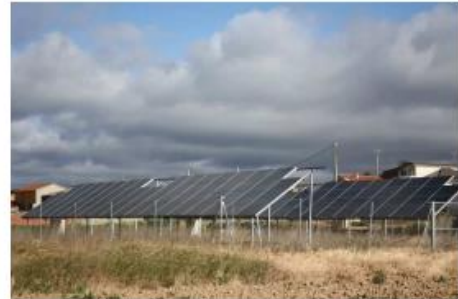
Placas solares fijas en Navianos de Valverde
